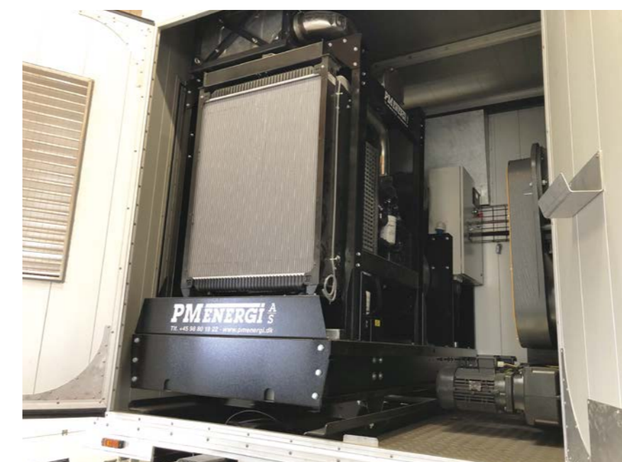
Maschinenraum mit Dieselgenerator und Hydraulikstation.
